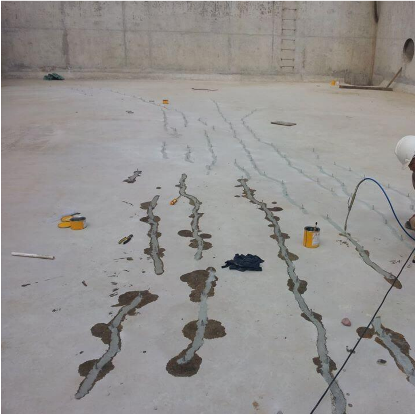
Chống thấm sàn bê tông bằng cần bơm keo máy Pu – Epoxy
