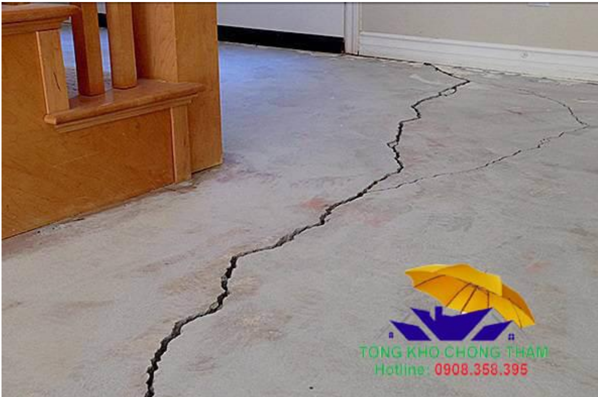
Tình trạng vết nứt của sàn bê tông
