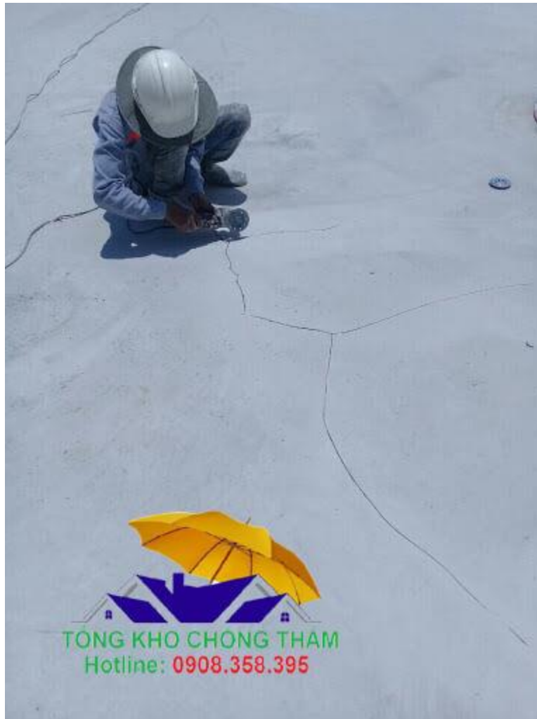
Tình trạng vết nứt bê tông
