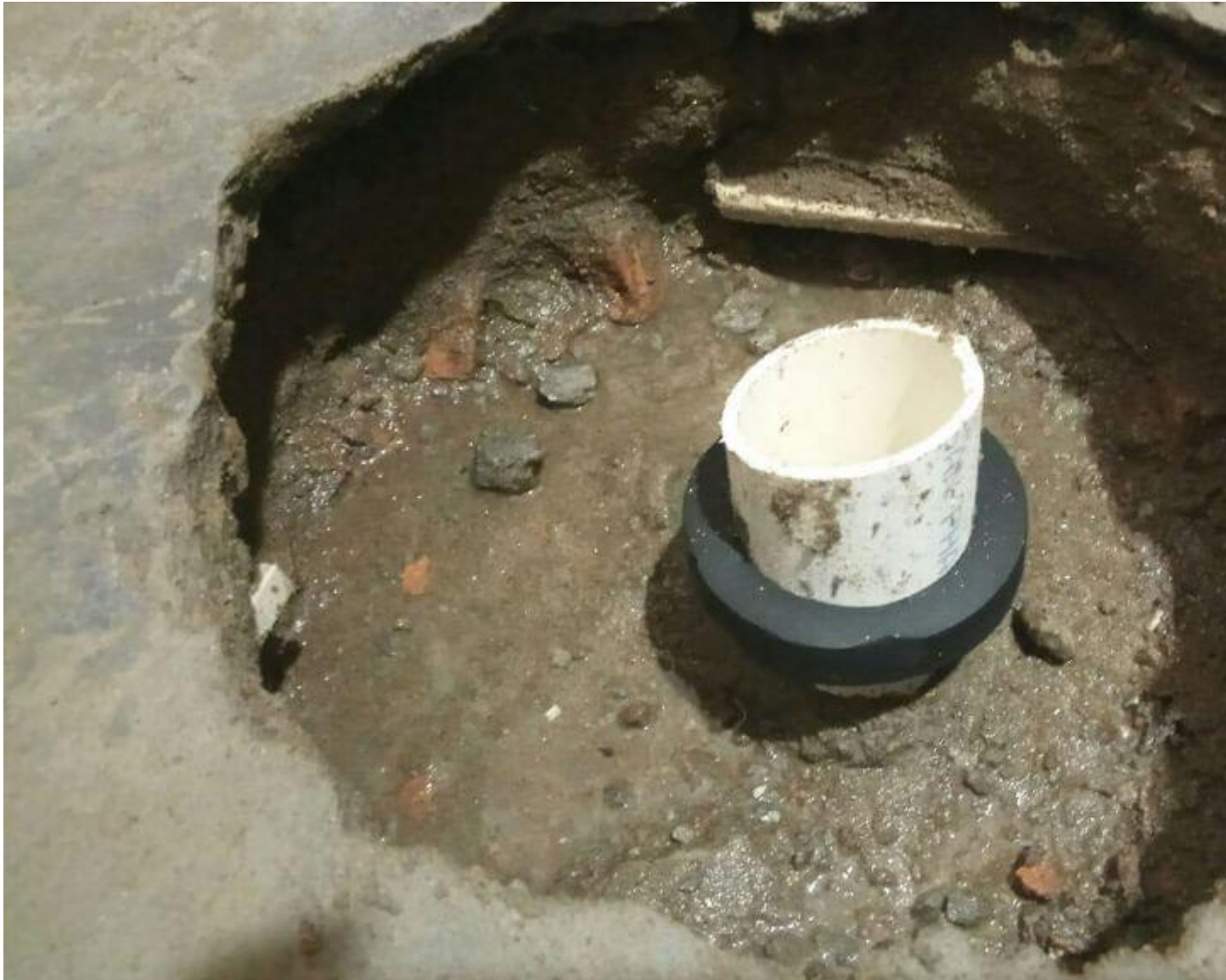
Chống thấm cổ ống xuyên tường sàn nhà bằng thanh trương nở
