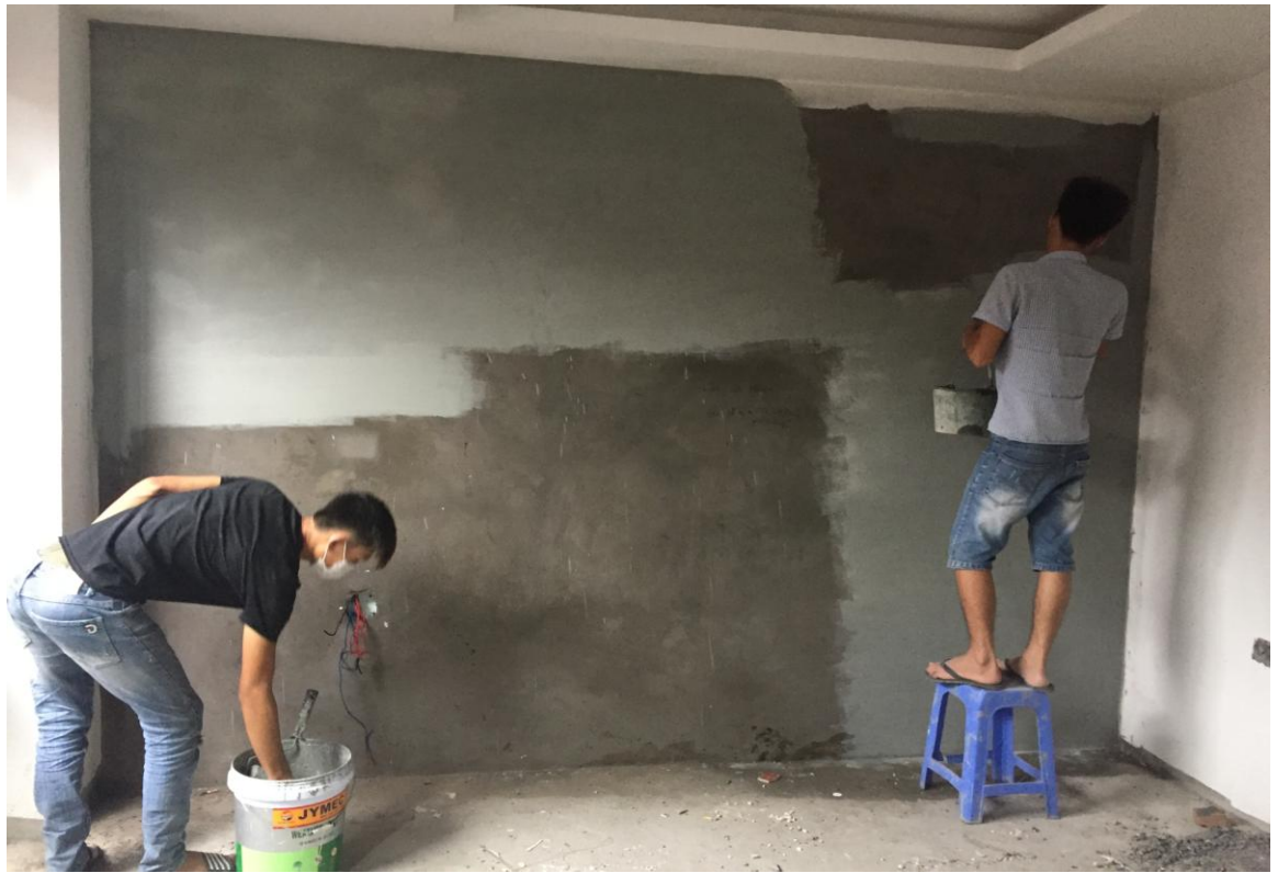
Hình ảnh: Thợ quét hỗn hợp chống thấm Water Seal DPC + Fosmix TGP chống thấm ngược bức tường bên trong giáp ranh nhà hàng xóm.
