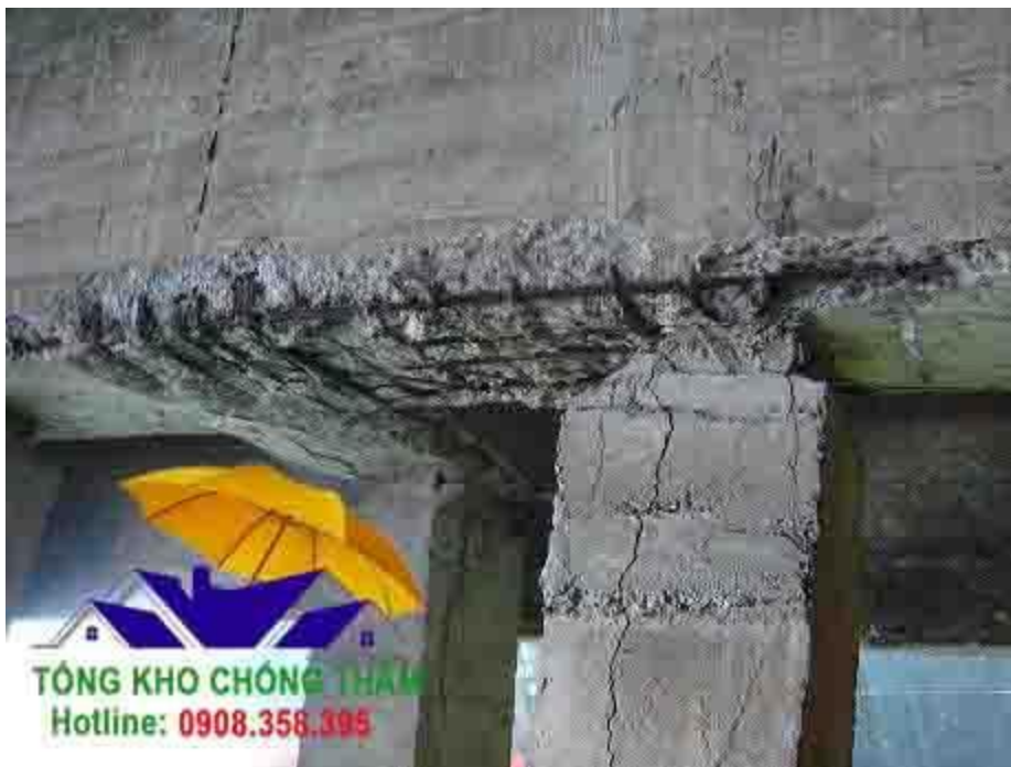
Hình ảnh ăn mòn cốt thép trong bê tông
