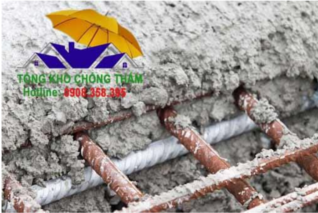
Ăn mòn bê tông cốt thép
