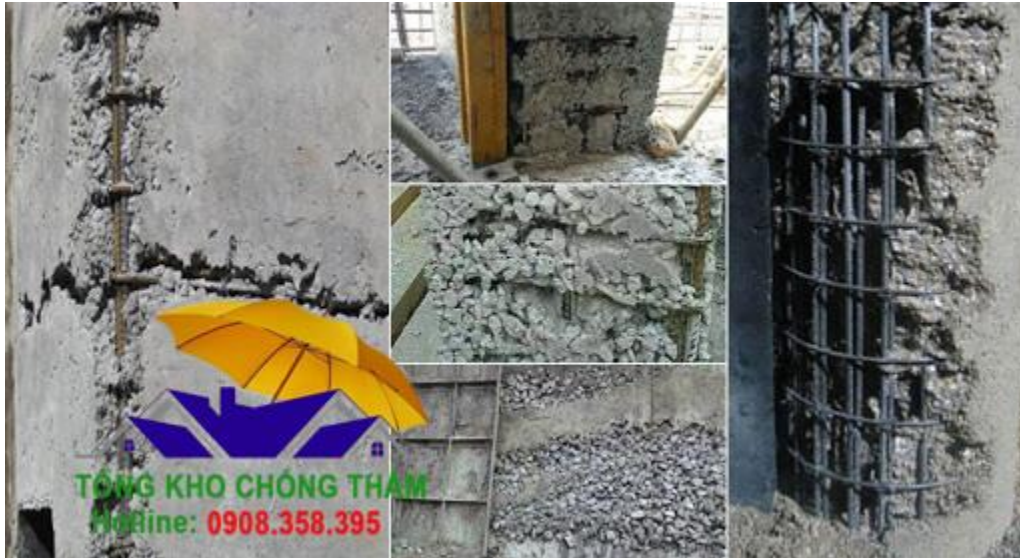
Tình trạng bê tông bị rỗ tổ ong
