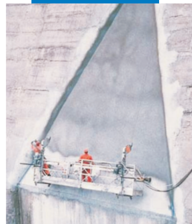
Hình ảnh Mapelastic được thi công chống thấm cho đập bằng phương pháp phun
