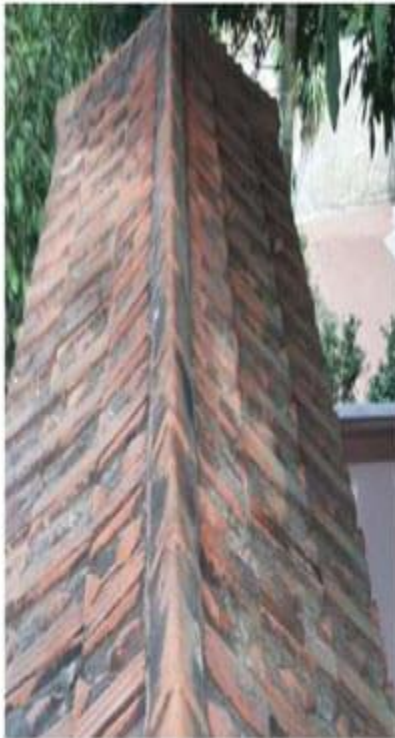
Mái ngói bị rêu mốc
