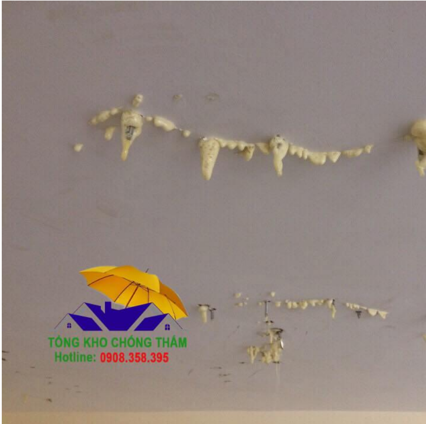
Nứt trần nhà
